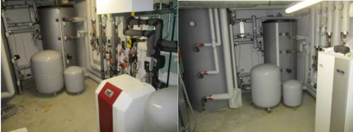
Abbildung 2: Technikraum von Haus 2 (links) und Haus 4 (rechts) (Quelle: Franz Oberndorfer GmbH)
