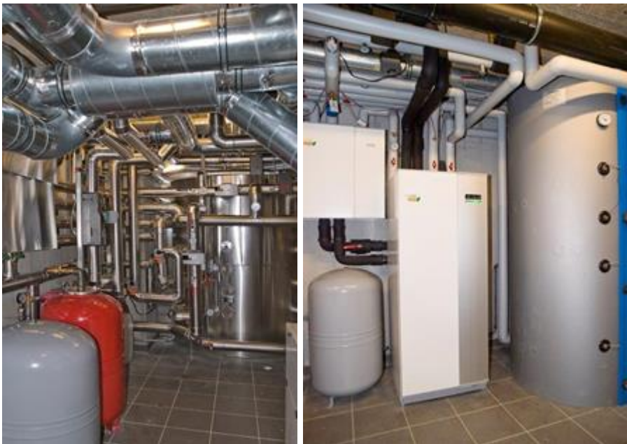
Abbildung 2: Ansicht des neu gebauten Technikraums ALWI Solarbüro (Quelle: FIN - Future is Now GmbH)
