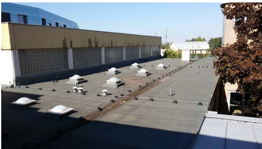
Abbildung 2: Bitumendach von Umkleide, Duschen und Gang; Links davon der Turnsaal (mit Glasbausteinen und Ausblühungen der vorgehängten Stahlbetonattika, im Hintergrund der Neubau (blau).
