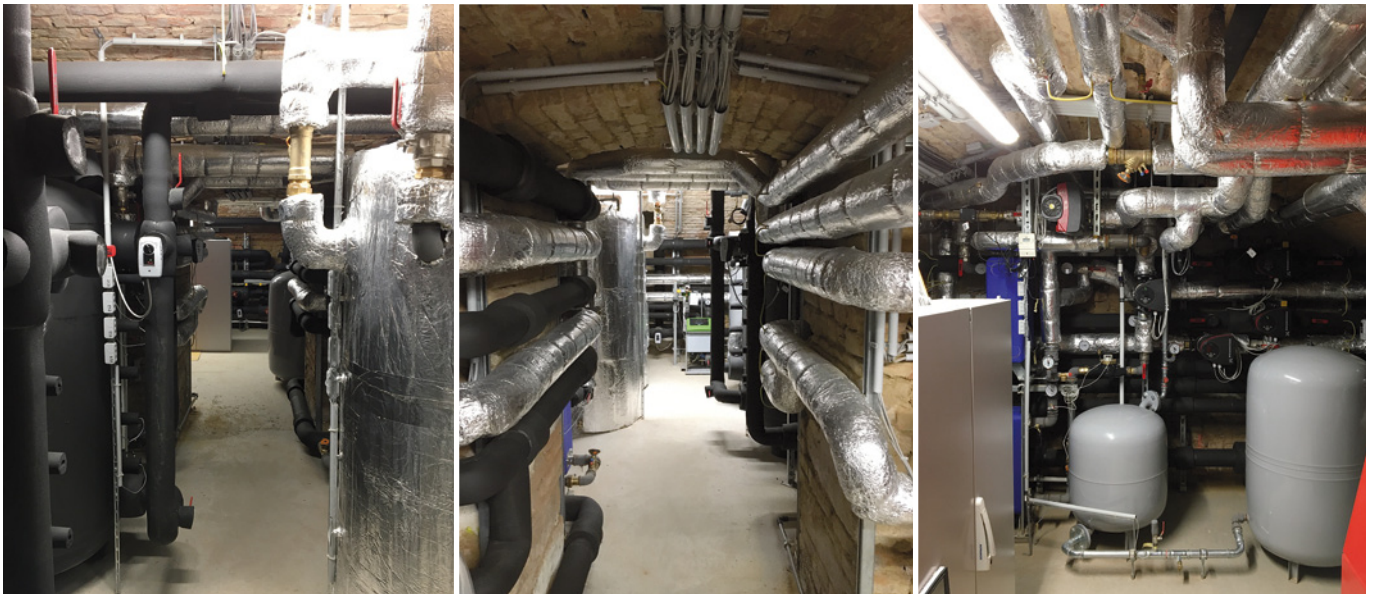
Im Keller des Wohnhauses ist die Haustechnikzentrale für das Energienetz untergebracht.
