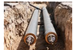
Fernwärmeleitungen, Quelle: fefufoto, fotolia.de
