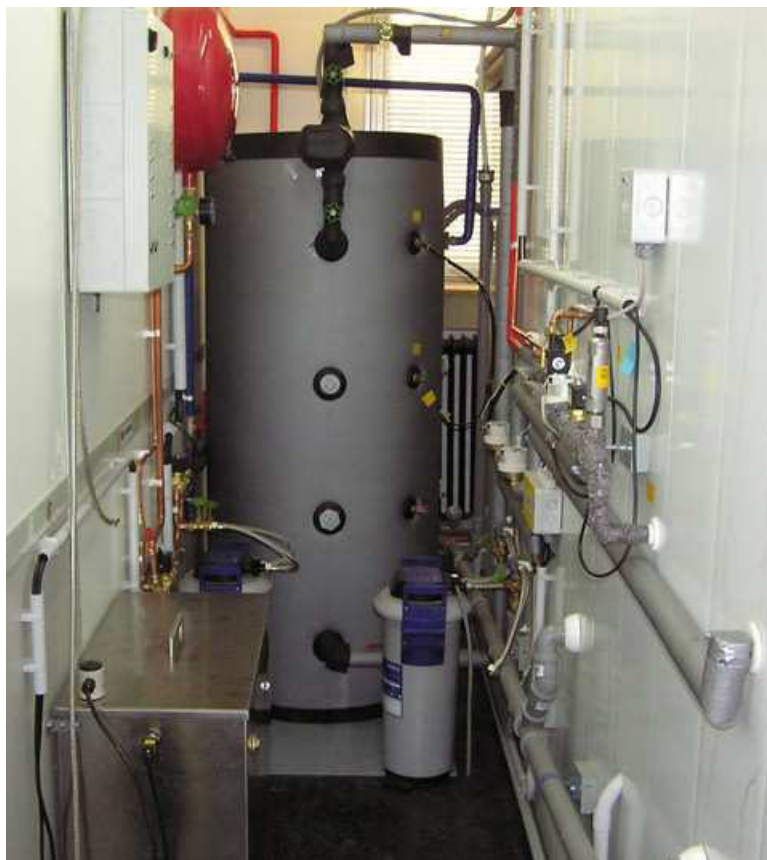
Bild 2: Zulaufwasser Aufbereitung neben der Klimakammer
