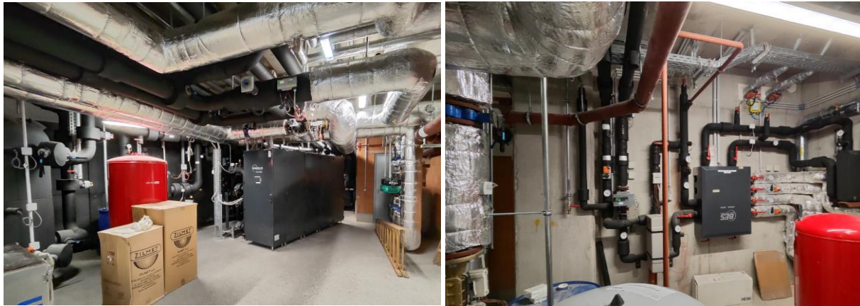
Abbildung 4 Technikzentrale mit Wärmepumpe, Pufferspeicher und Solarstation
