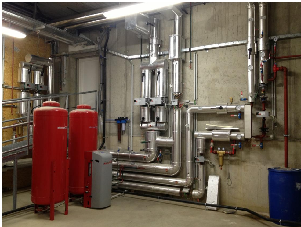
Bild: Rücklaufgruppe Solarkreis
