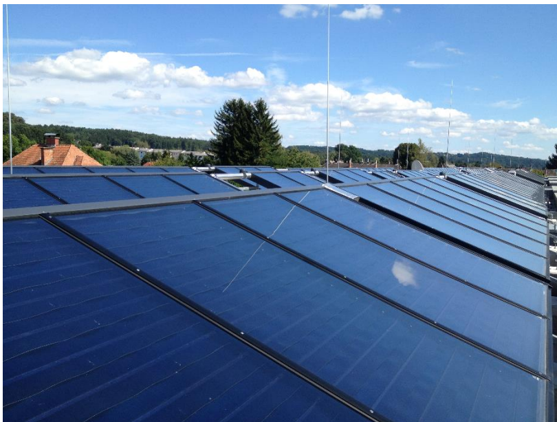
Bild: Kollektorfläche MFH Generationenwohnen
