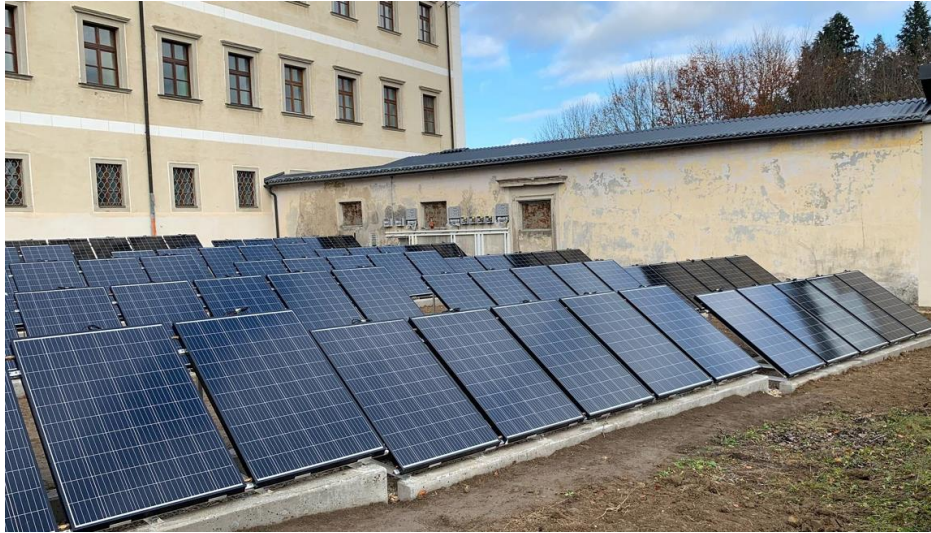
Abbildung 1: Ansicht der am Nebengebäude aufgestellten PVT-Kollektoren (Quelle: BES)
