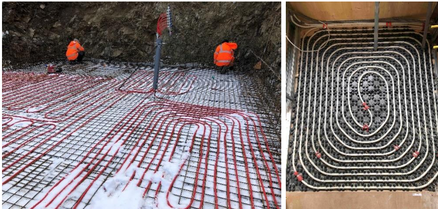
Abbildung 2: Verlegung der Bauteilaktivierung der Bodenplatte (links), Fußbodenheizung im OG (rechts) (Quelle: Bauherr)
