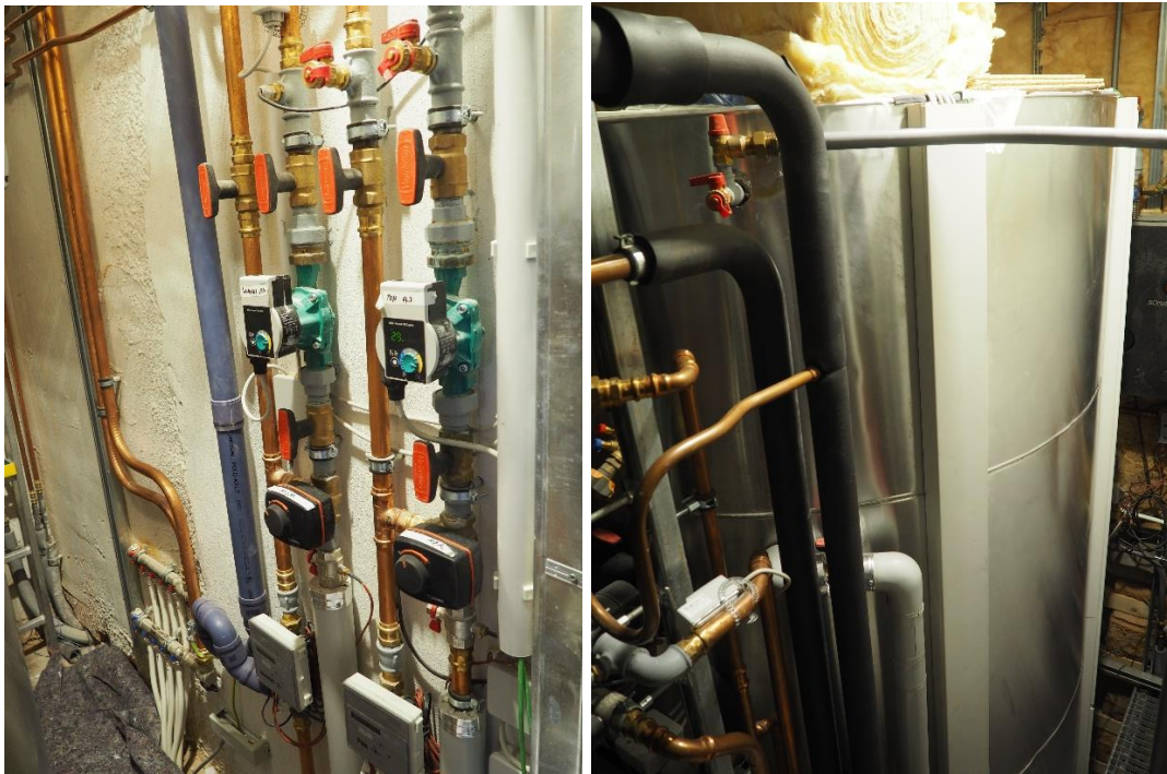
Abbildung 2: Heizraum im EG (links) und im DG (rechts) inkl. Pufferspeicher (Quelle: AEE INTEC)
