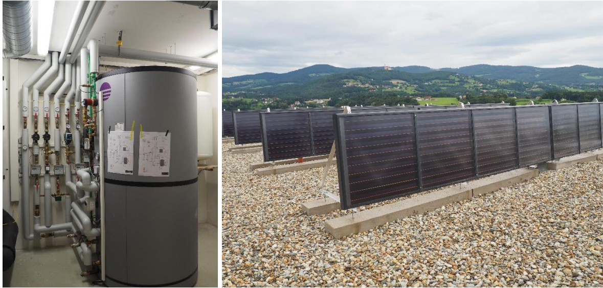
Abbildung 2: Heizraum (links) und Kollektoren am Dach (rechts) (Quelle: AEE INTEC)
