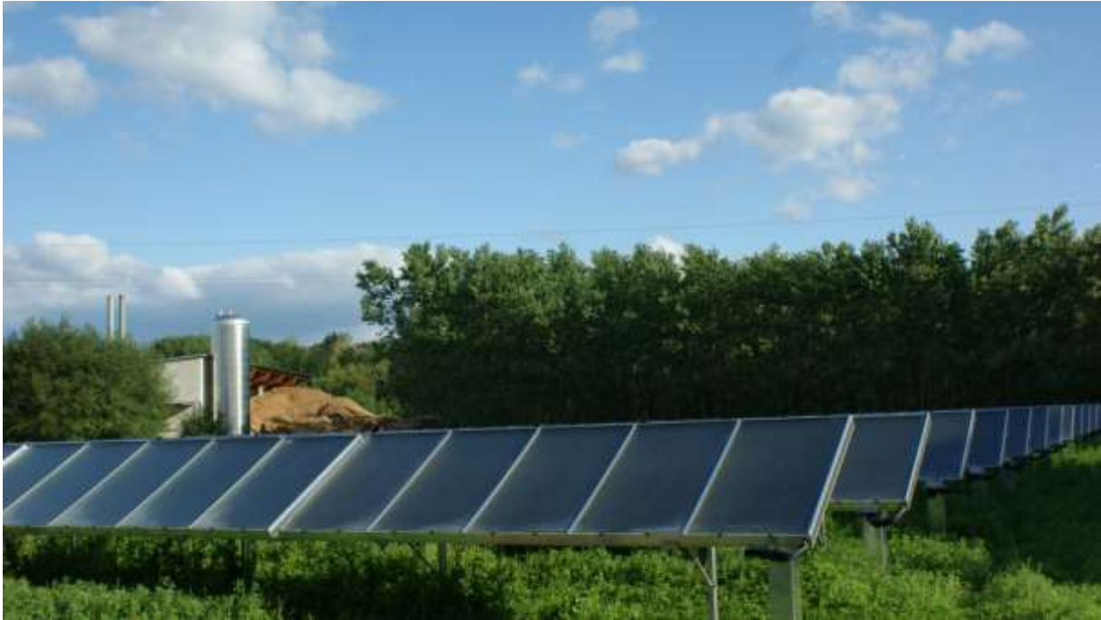
Abbildung 1: Kollektorfeld sowie im Hintergrund der 100 m 3 Pufferspeicher beim Heizwerk Nahwärme St. Ruprecht (Quelle: AEE INTEC)
