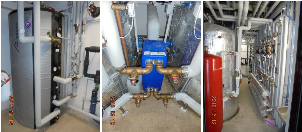
Abbildung 2: Sekundärpufferspeicher (linke Abbildung) und Primärpufferspeicher mit Solarwärmetauscher (mittlere Abbildung) und mit Verteileranlage der Wärmeverbraucher (rechte Abbildung) (Quelle: Stadtamt Saalfelden)
