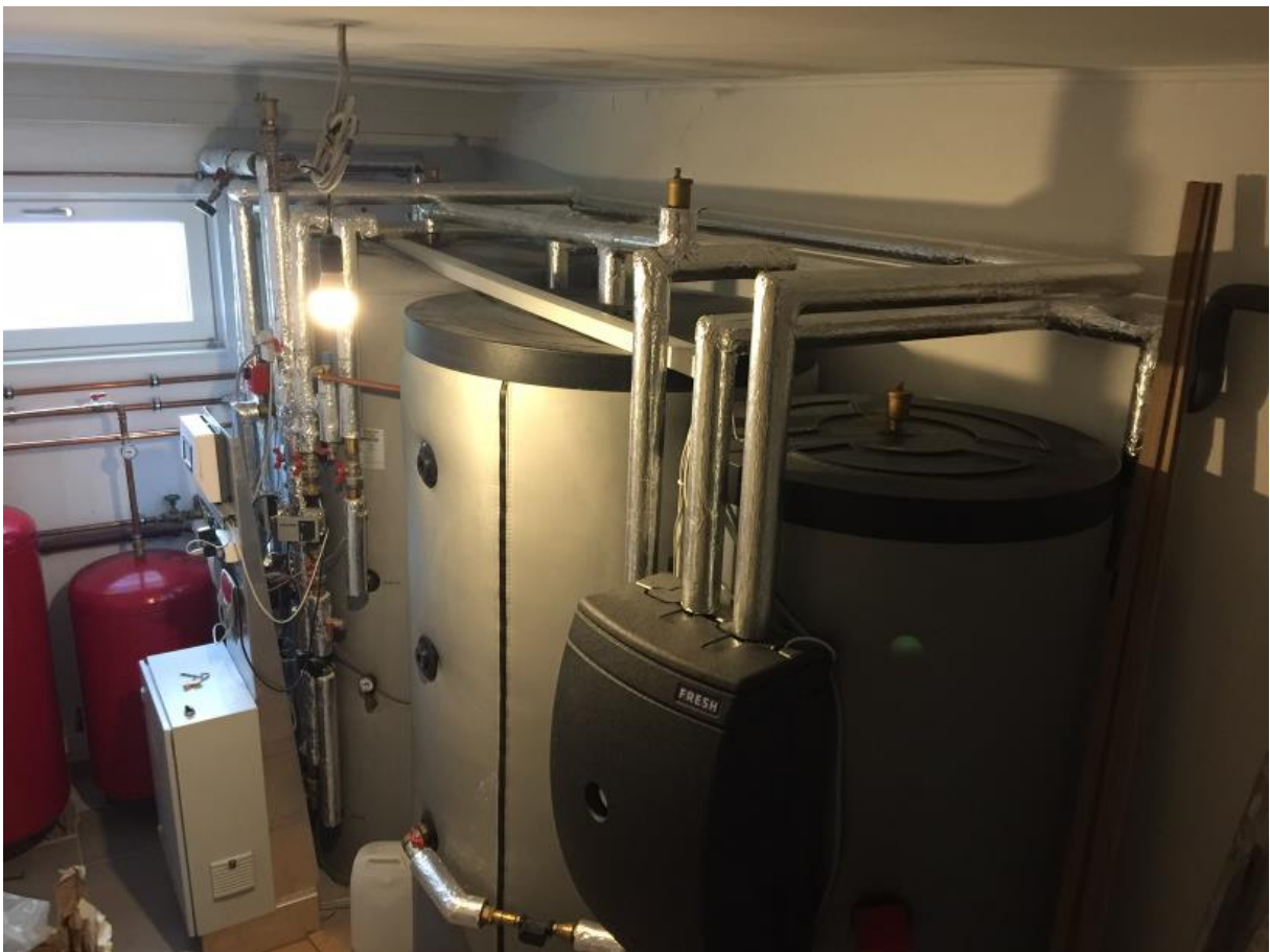
Abbildung 2: Technikraum des Solarhauses Fasching (Quelle: Bauherr)
