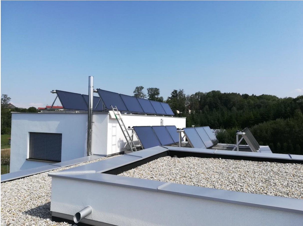
Abbildung 3: Nordost-Dachansicht der Solarthermie-Kollektoren (oben), (Quelle: AIT)
