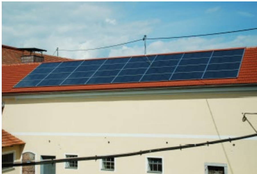
Abbildung 2: Westliches Luftkollektorfeld mit 65,4 m 2 (Quelle: FHOÖ F&E GmbH)
