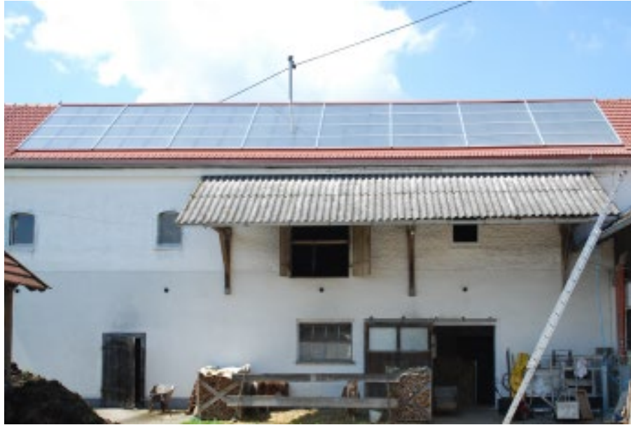
Abbildung 1 Östliches Luftkollektorfeld mit 65,4 m 2 (Quelle: FHOÖ F&E GmbH)
