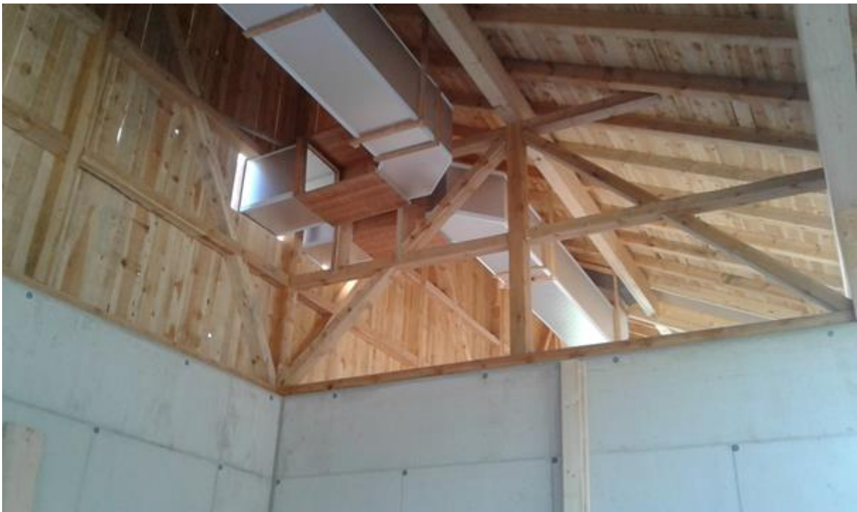
Abbildung 1: Solar-Luftleitungen im Dach der Trocknungshalle (Quelle: Bauherr)
