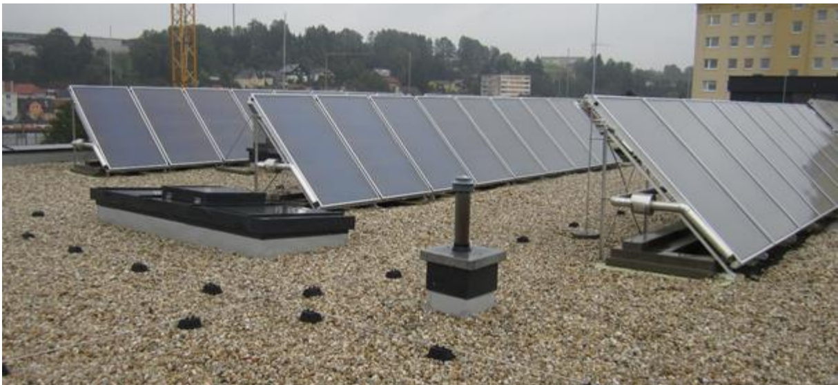
Abbildung 2: Kollektorfeld auf dem Flachdach des DLZ Grieskirchen. Quelle: AIT
