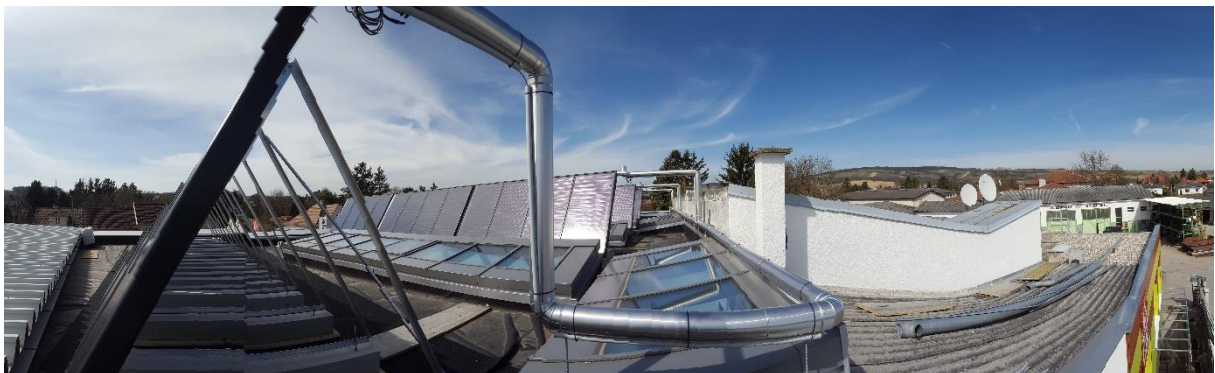
Abbildung 2: Dachansicht der Solaranlage (Quelle: AIT)
