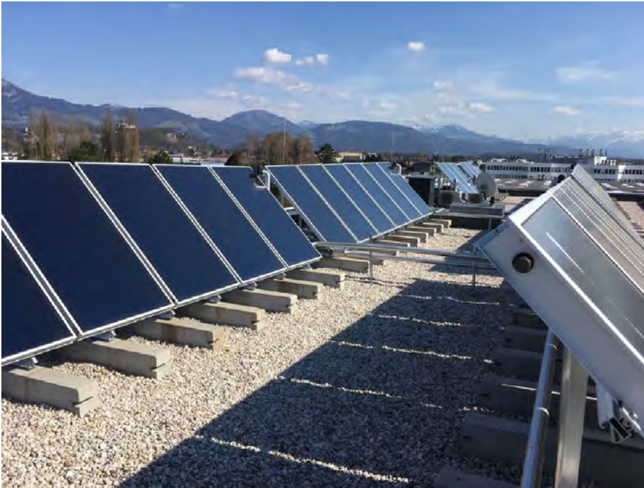
Solaranlage am Flachdach aufgeständert
