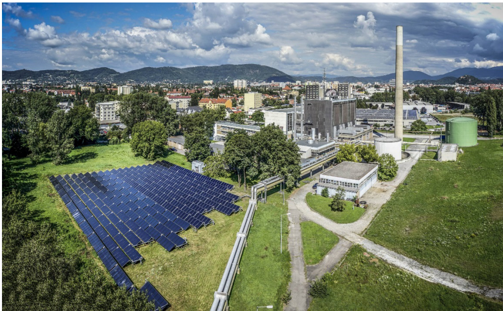
Abbildung 1: Luftbild Ausbaustufe 3 am Gelände des Fernheizwerks
