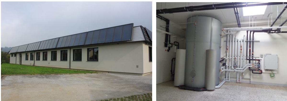
Abbildung 1: thermische Solaranlage mit 10.000 Liter Pufferspeicher
