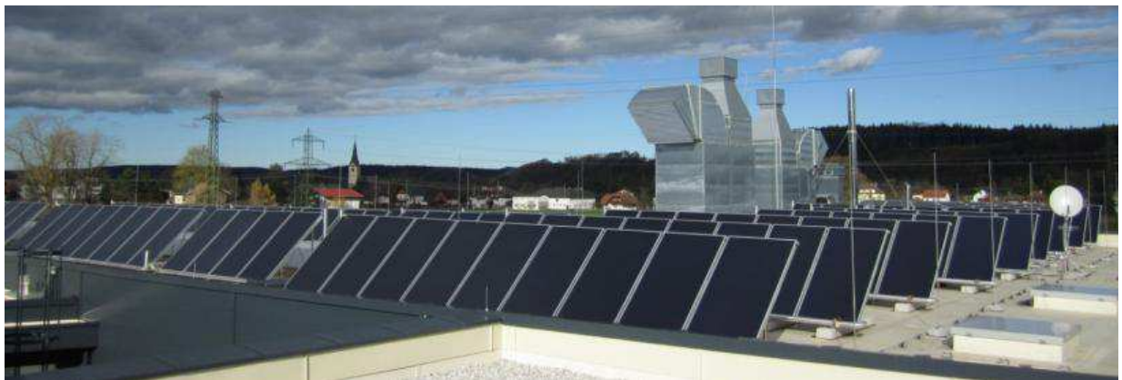
Abbildung 15: Aufständerung der Kollektorreihen (Bildquelle: AIT).
