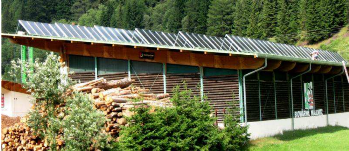
Abbildung 21: Ansicht des Heizwerks „Biowärme Mallnitz“ mit den aufgeständerten Kollektoren (Bildquelle: Hoval Gesellschaft m.b.H.)
