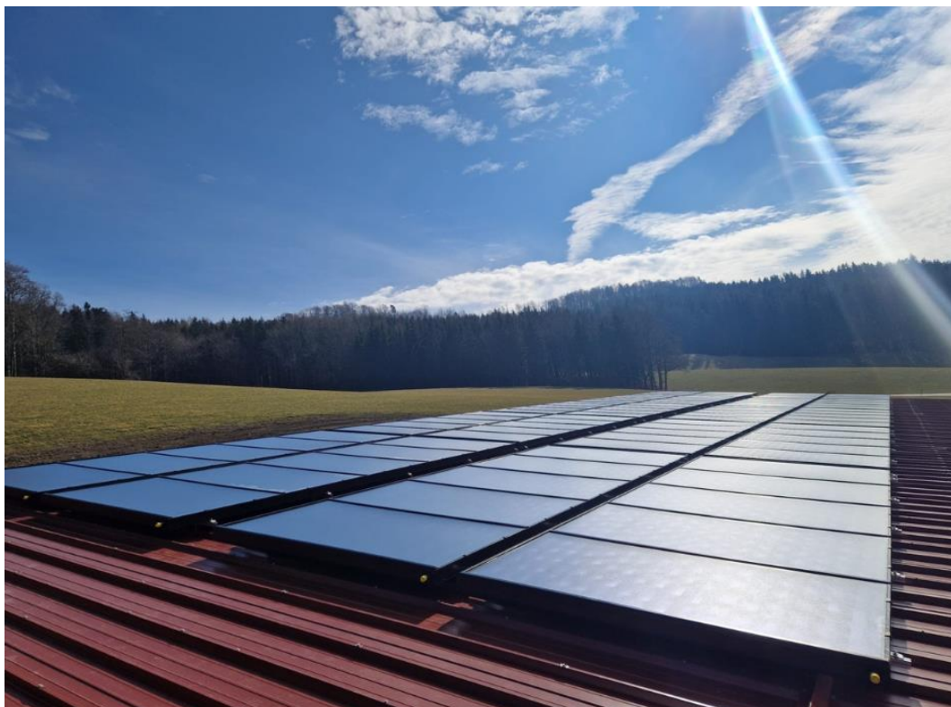
Abbildung 1: Solaranlage am Dach
