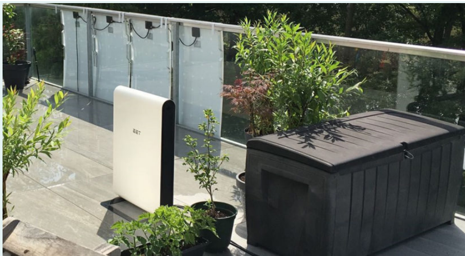
Abbildung 51: Stromspeicher. (Quelle: EET)
