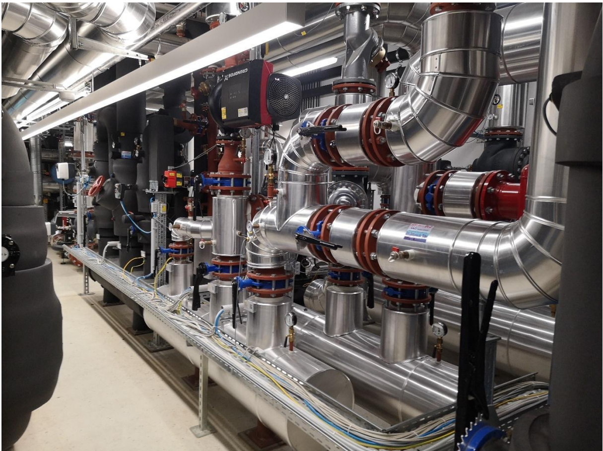
Abbildung 7: Anlagentechnik im Betriebsraum (Quelle: AEE INTEC)
