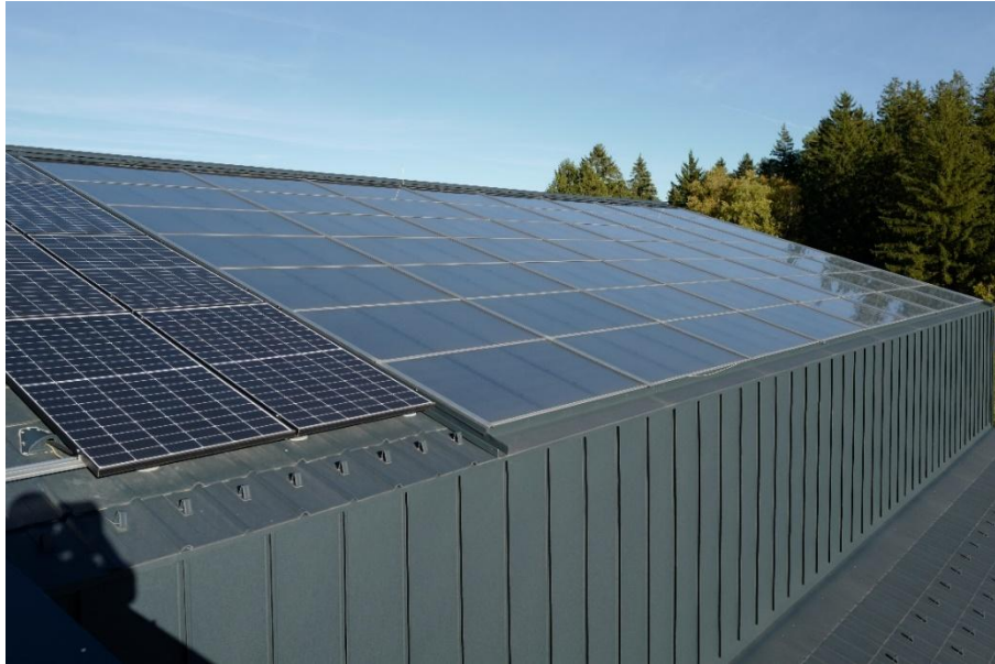
Abbildung 36 südwestliches Luftkollektorfeld mit insgesamt 114,5 m 2 und ein Teil der 17 kWp PV-Anlage am Ziegenstall (Quelle: Rudolf Kutschera)
