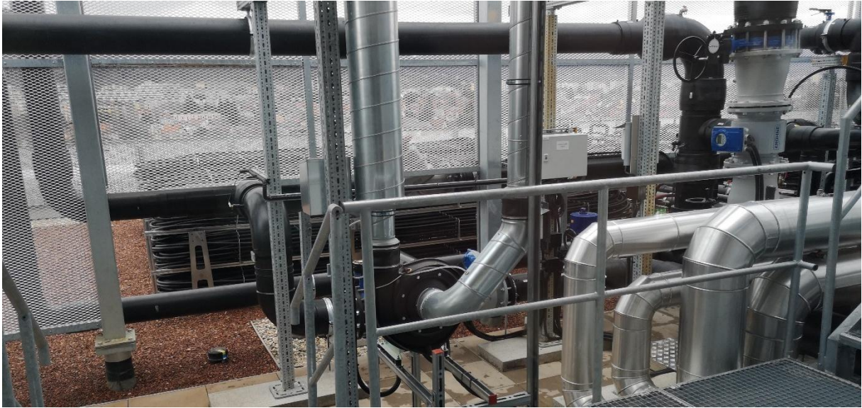
Abbildung 6: Anlagentechnik am Dach, mit Solarabsorbern im Hintergrund (Quelle: AEE INTEC)
