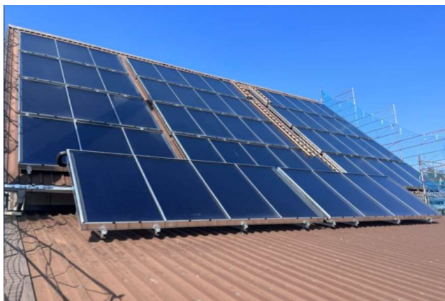
Abb. 1 Kollektorfläche SÜD 163 m 2 , 3 Teilfelder
