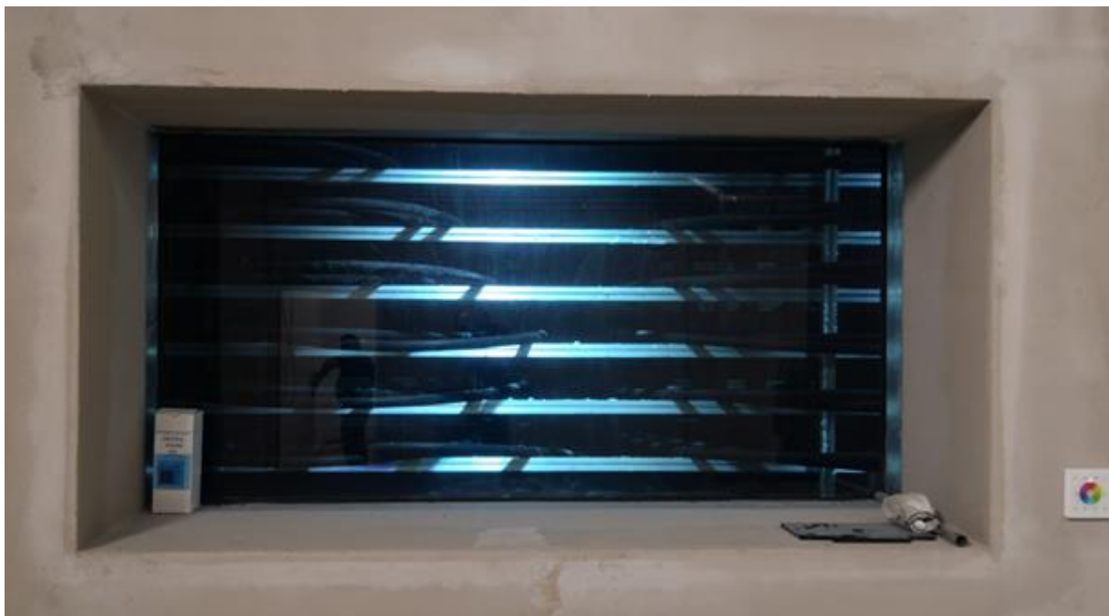
Abbildung 96: Sichtfenster in den Eis-Energiespeicher bei der Anlage Wiegert Fresh (AEE INTEC).
