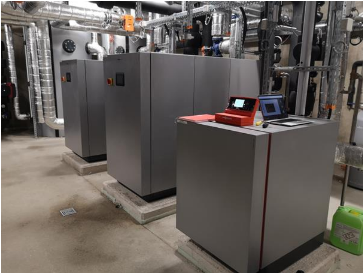
Abbildung 97: Technikraum mit den 3 Wärmepumpen bei der Anlage Wiegert Fresh (AEE INTEC).
