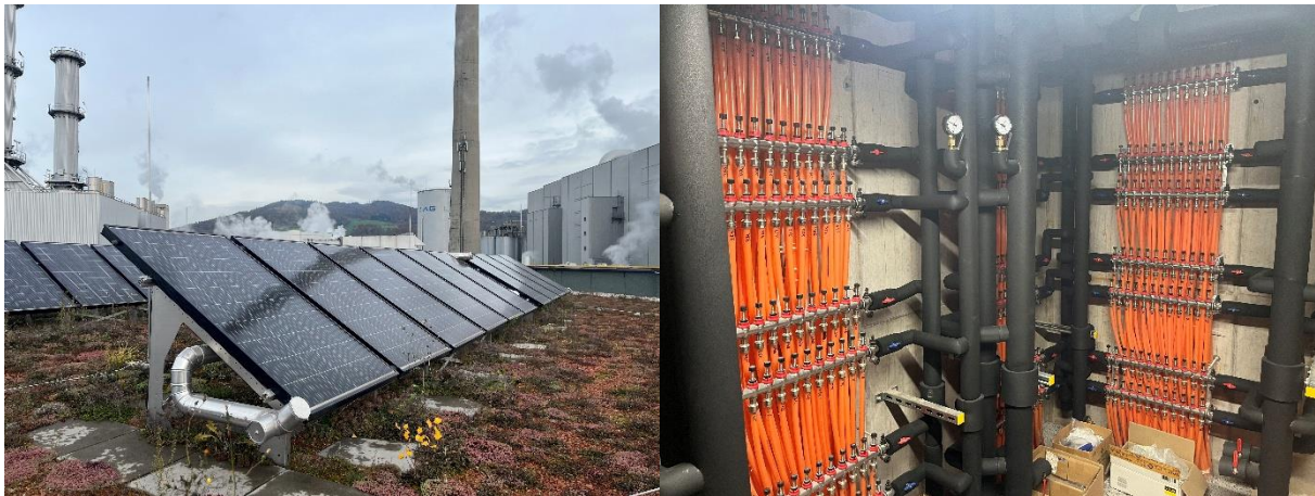
Abbildung 57: Installierte PVT-Anlage am Dach & Erdkollektoranschluss im Technikraum
