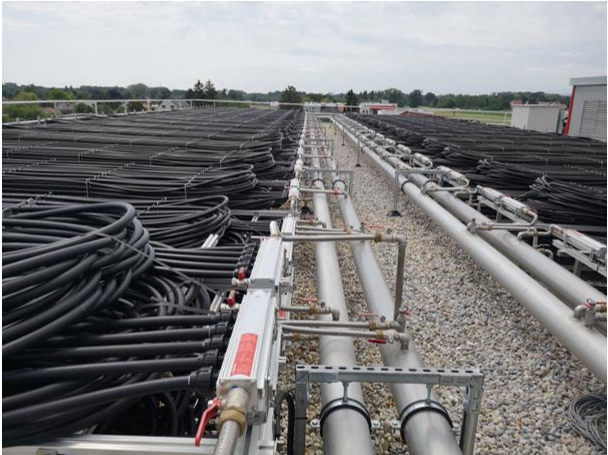
Abbildung 95: Solar-Luft-Kollektor Viessmann SLK-600 am Dach des Firmengebäudes (AEE INTEC).
