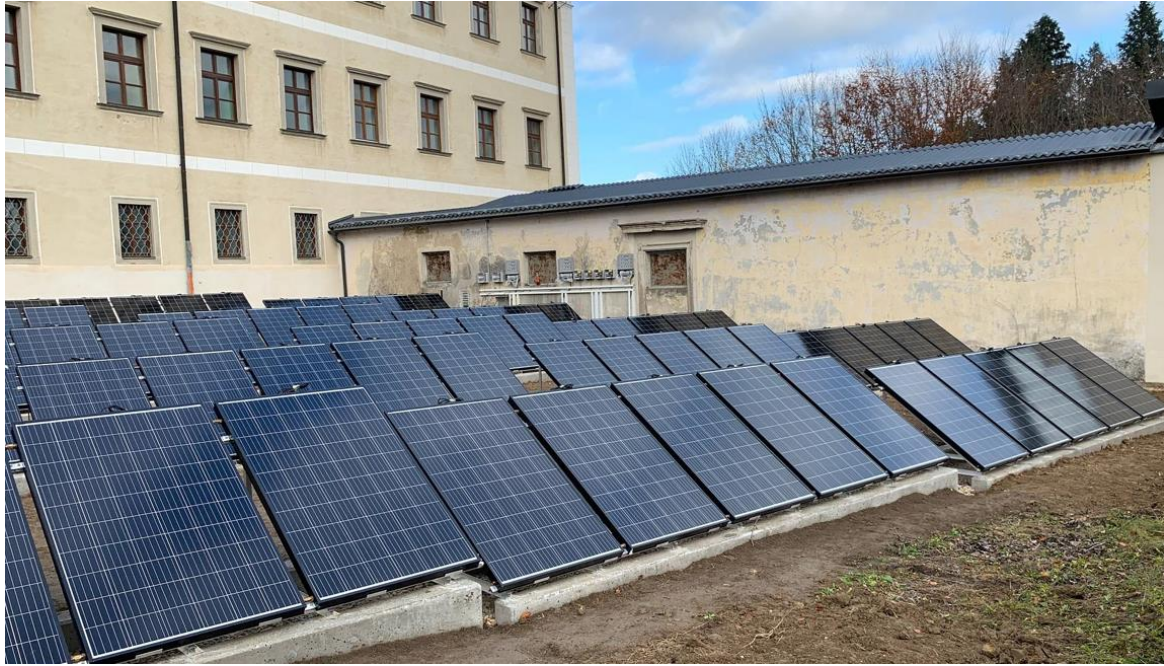
Abbildung 25: Ansicht der am Nebengebäude aufgestellten PVT-Kollektoren (Quelle: BES)
