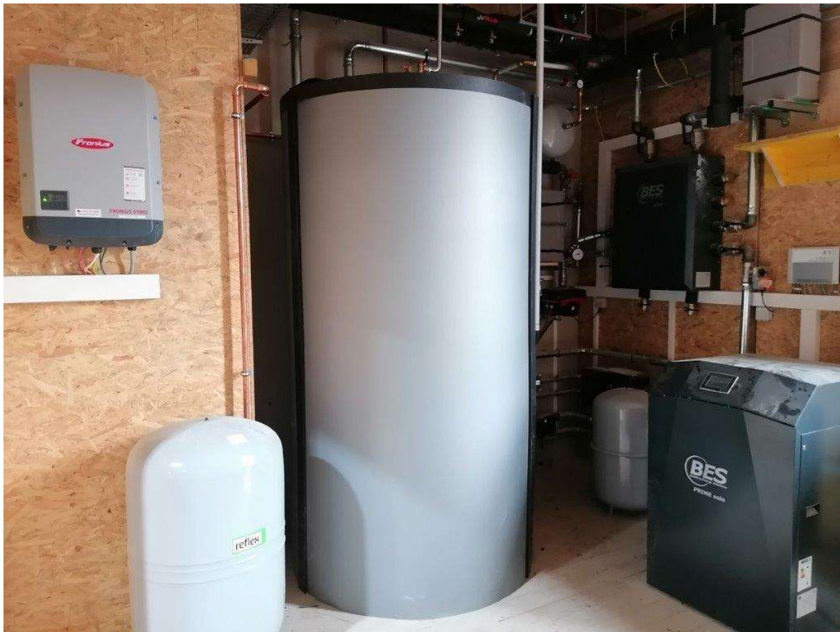
Abbildung 4 Technikzentrale mit Wärmepumpe und Wechselrichter
